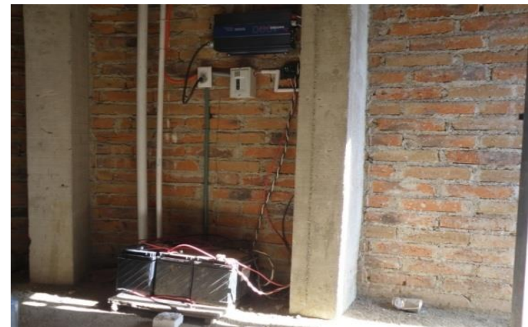
Inversor marca samlex con sus respectivas características que nos servirá para convertir la corriente directa CD de las celdas fotovoltaicas CFV a corriente alterna CA
